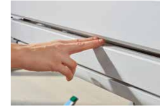
▲ Notwendige Zwischenräume sind so groß bemessen, dass sie bei der Reinigung erreichbar sind.
